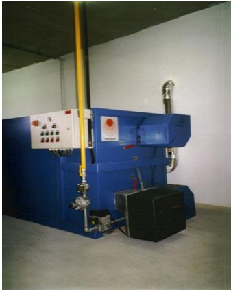
Générateur en chaufferie
