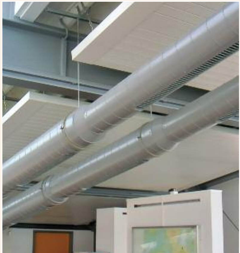
Panneaux HKE-CS suspendus sous toiture. Version grande largeur
